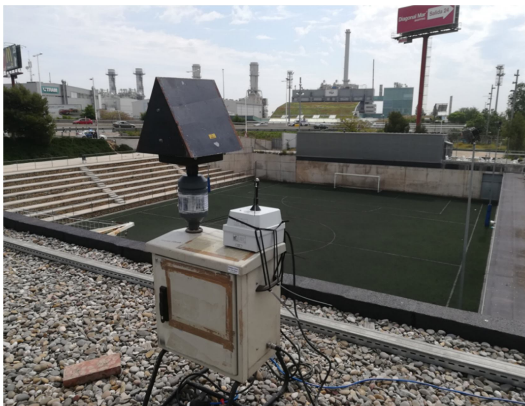
FIGURA 7. Equip instal·lat al sostre de l'edifici del Centre Esportiu La Mina (Sant Adrià del Besòs).
